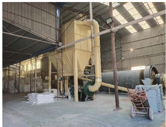
现有工程除尘措施
