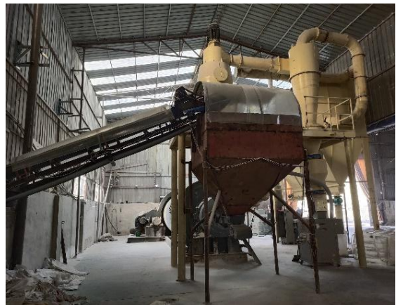
现有工程除尘措施
