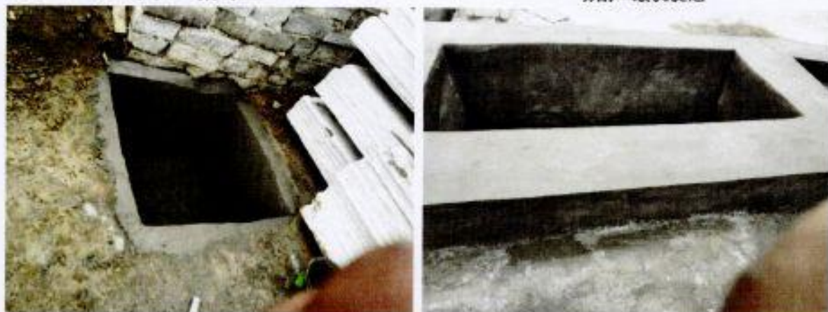
车辆冲洗沉淀池
